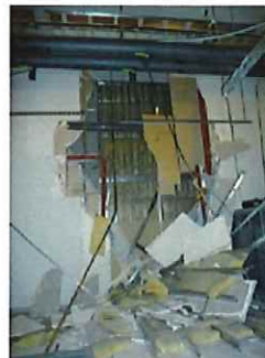
間仕切壁の被害
