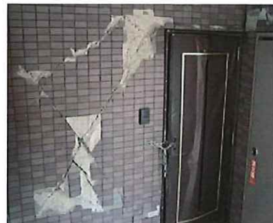
玄関ドアと RC 非構造壁の被害
